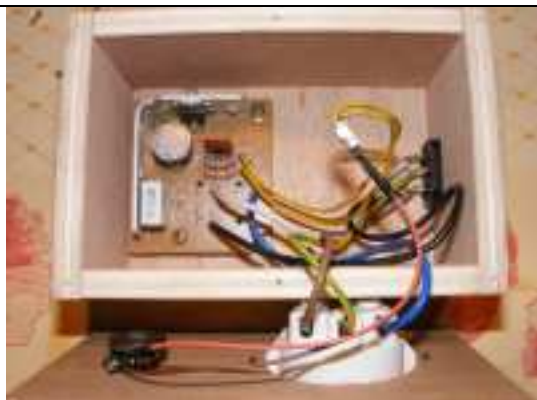
Le gradateur fixé au fond du boîtier
